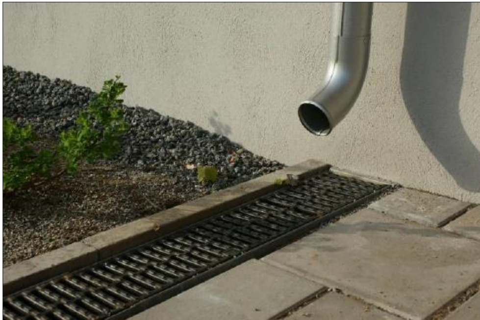
Dagvattenränna. Bild: Sweco
