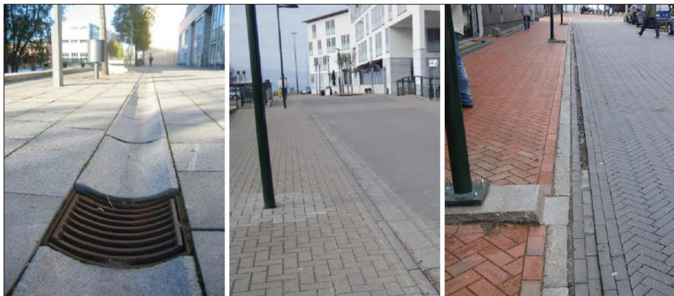
Exempel på öppna dagvattenrännor. Bild: Sweco
