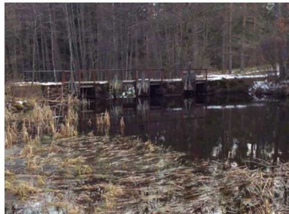
Luckorna vid Nykvarn är sönder och vattenståndet bestäms av betongklackar på olika nivåer. Enligt tekniska verken är det här som vattenståndet nedanför regleringsdammen bestäms och det verkar troligt med tanke på att Yxeredsån i fält ser ut att ha någon eller några meters fallhöjd därifrån och till Nykvarn.
