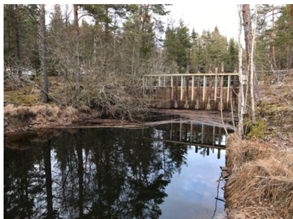
Yxerns regleringsdamm. Här ställs tappningen utifrån vattendomen. Tappningens storlek i m 3 /s bestäms utifrån både vattenstånd ovan och omedelbart nedanför regleringsdammen.
