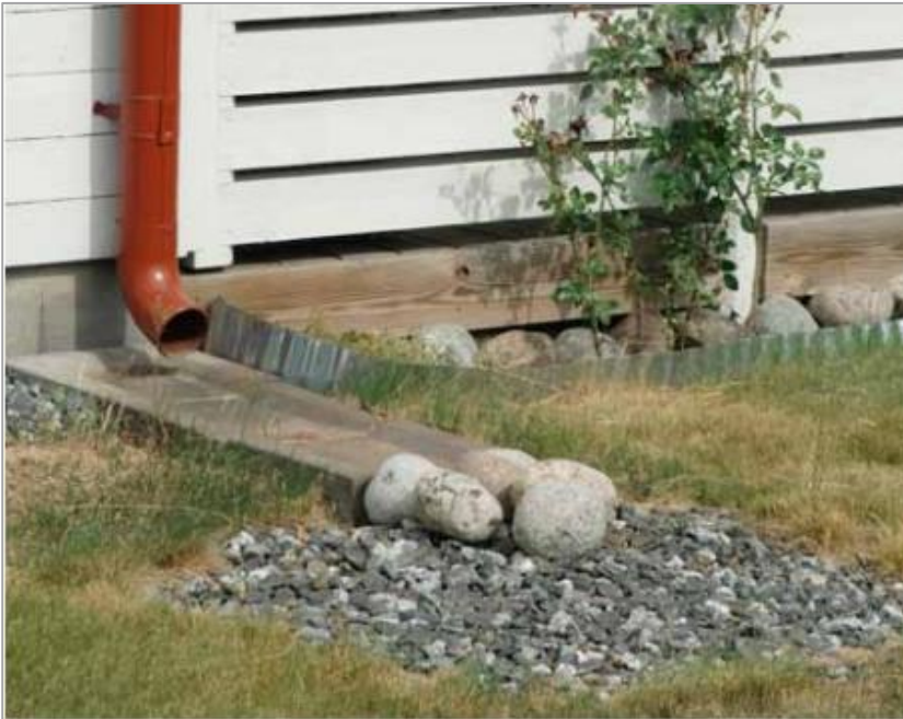
Figur 12: Avledning av takvatten via ränna till makadammagasin, bild Huddinge kommun.
