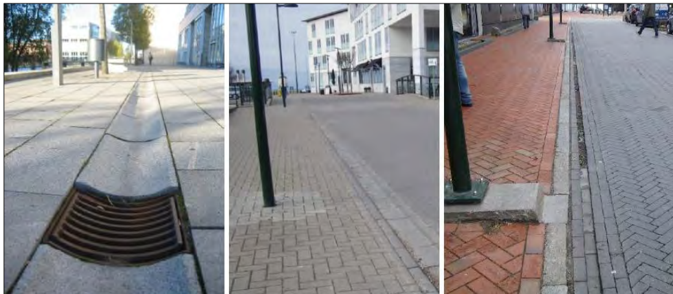
Exempel på öppna dagvattenrännor. Bild: Sweco
